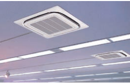
空調・換気設備
